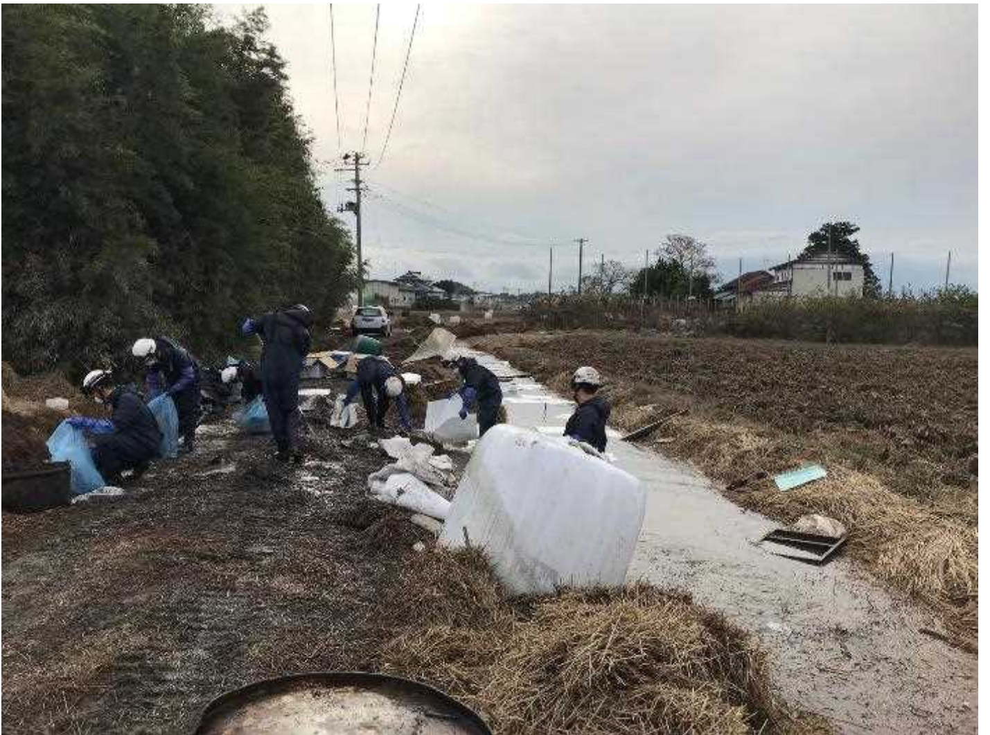
※大崎市鹿島台大迫地区での危険物漏洩に伴う活動状況
