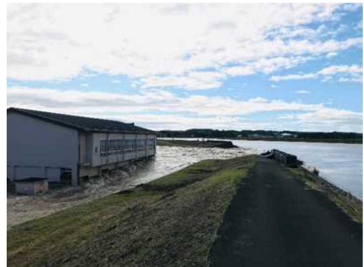
※大郷町粕川の堤防決壊箇所 幅約 100mが決壊した
